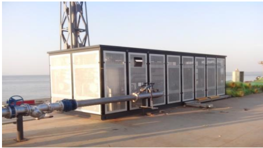
图 2.8-1 油气回收装置
