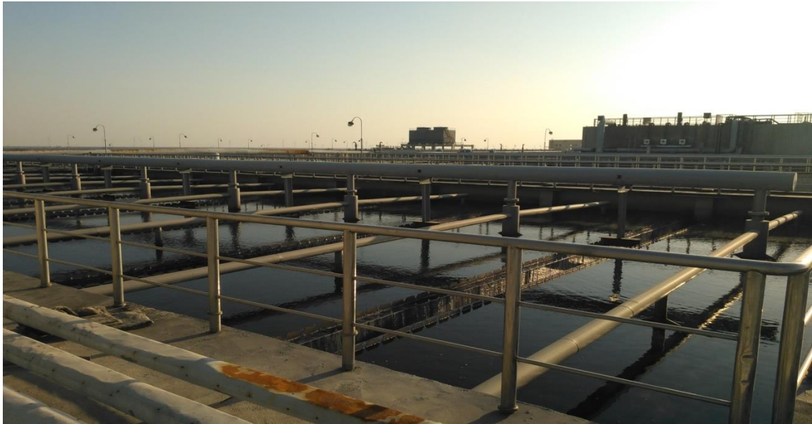
图 2.3-3 江苏虹港石化污水处理厂
