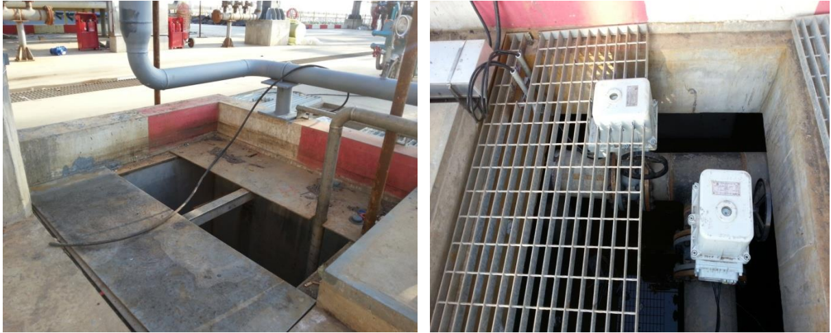
图 2.3-1 码头围污坎及污水泵
