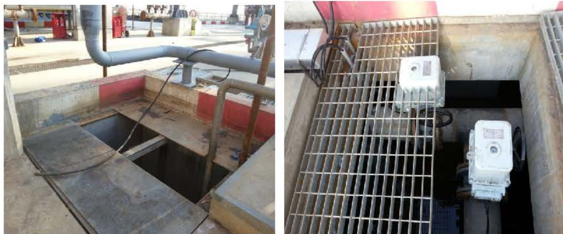
图 2.2-3 码头围污坎及污水泵
