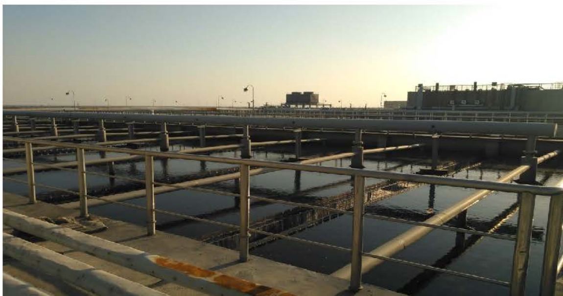
图 2.2-5 江苏虹港石化污水处理厂
