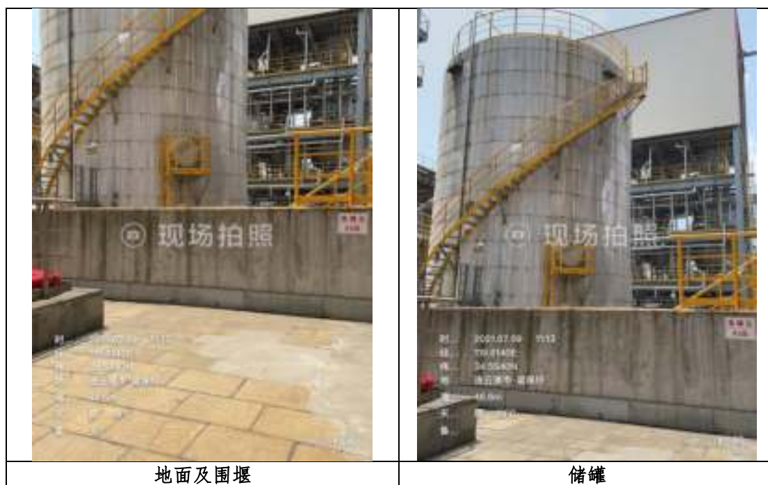
图 3.2-5 中间罐区安全、防渗防护措施
