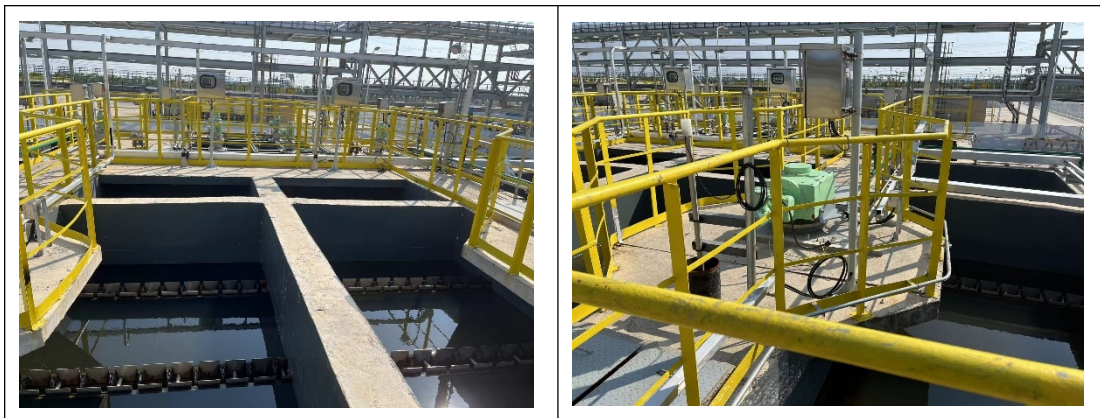
图 4.1-1 含油污水处理站现场照片
