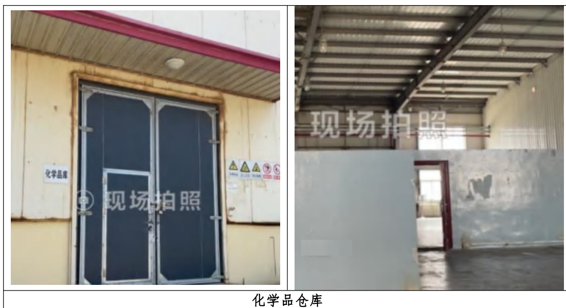
图 5.2-14 化学品库现场排查情况
