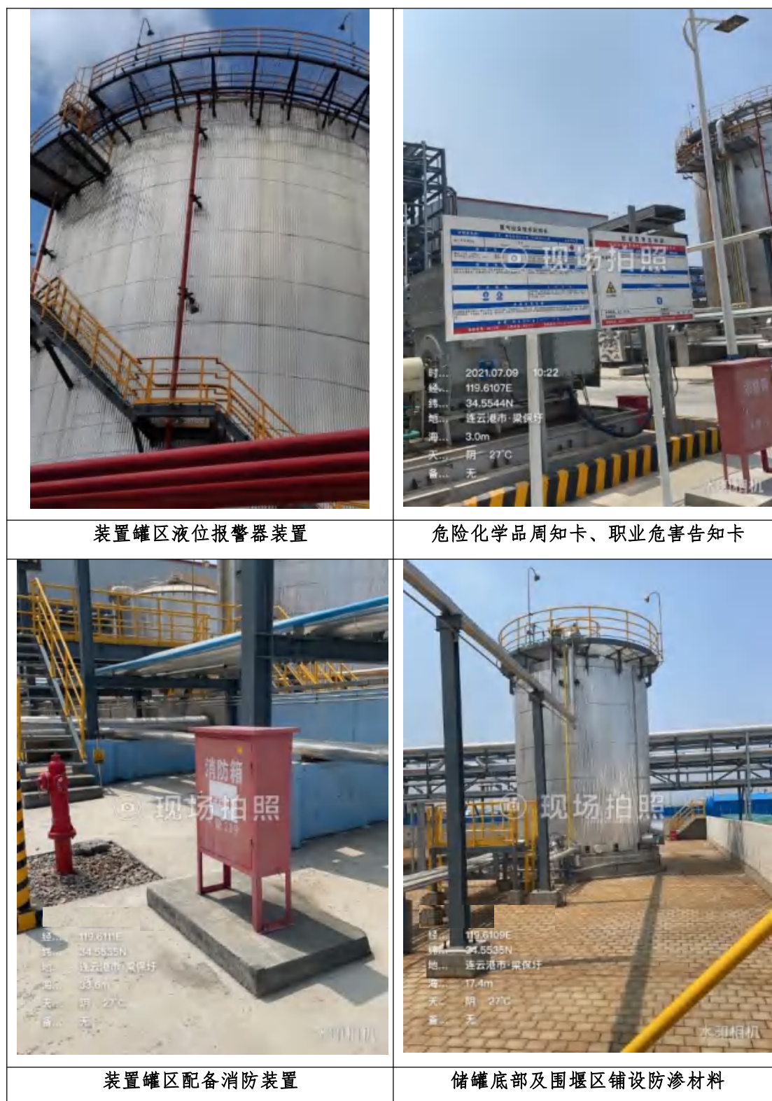
图 5.2-6 装置罐区安全、防渗防护措施
