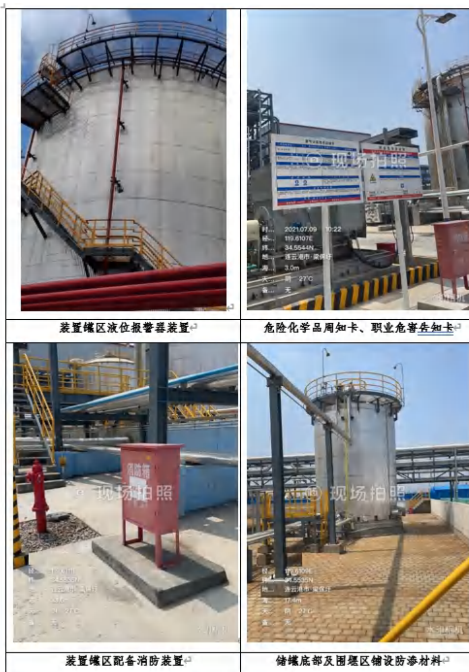
图 5.2-6 装置罐区安全、防渗防护措施
