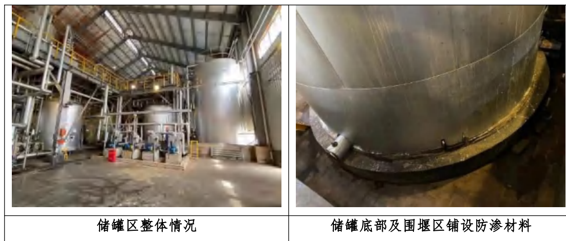
图 5.2-8 CMB 储罐土壤污染预防措施
